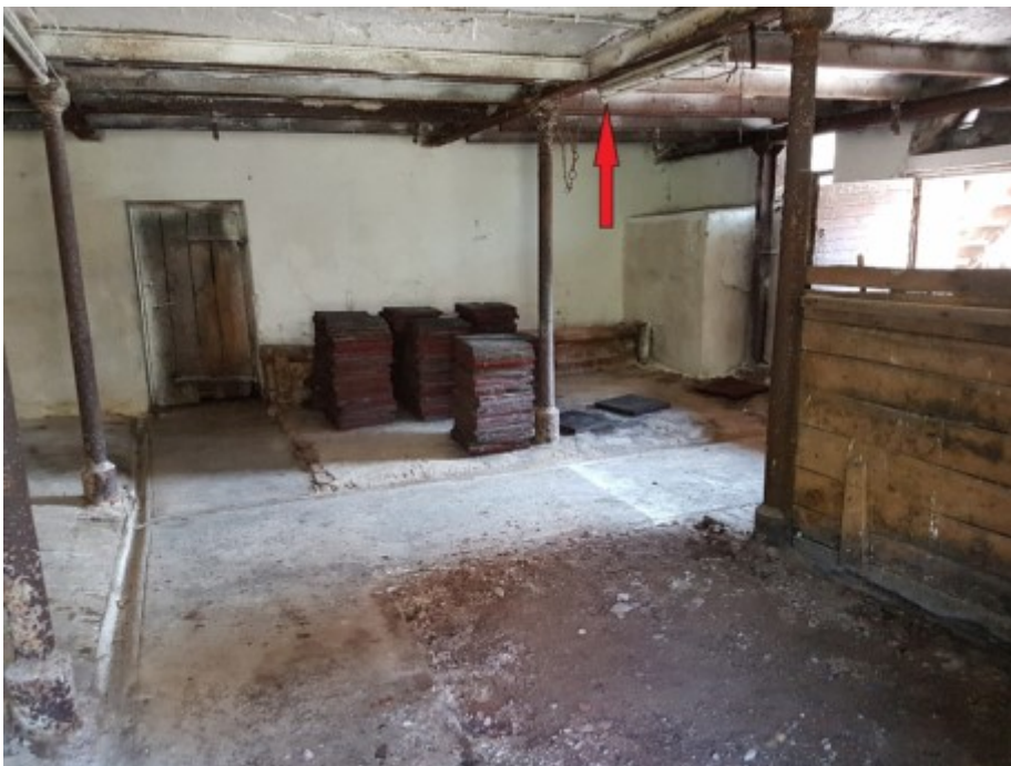
Innenbereich Stall mit den Neonröhren, die ausgerechnet am tiefsten Punkt angebracht sind...
